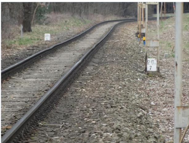
km 26+700 (deformacja toru)
