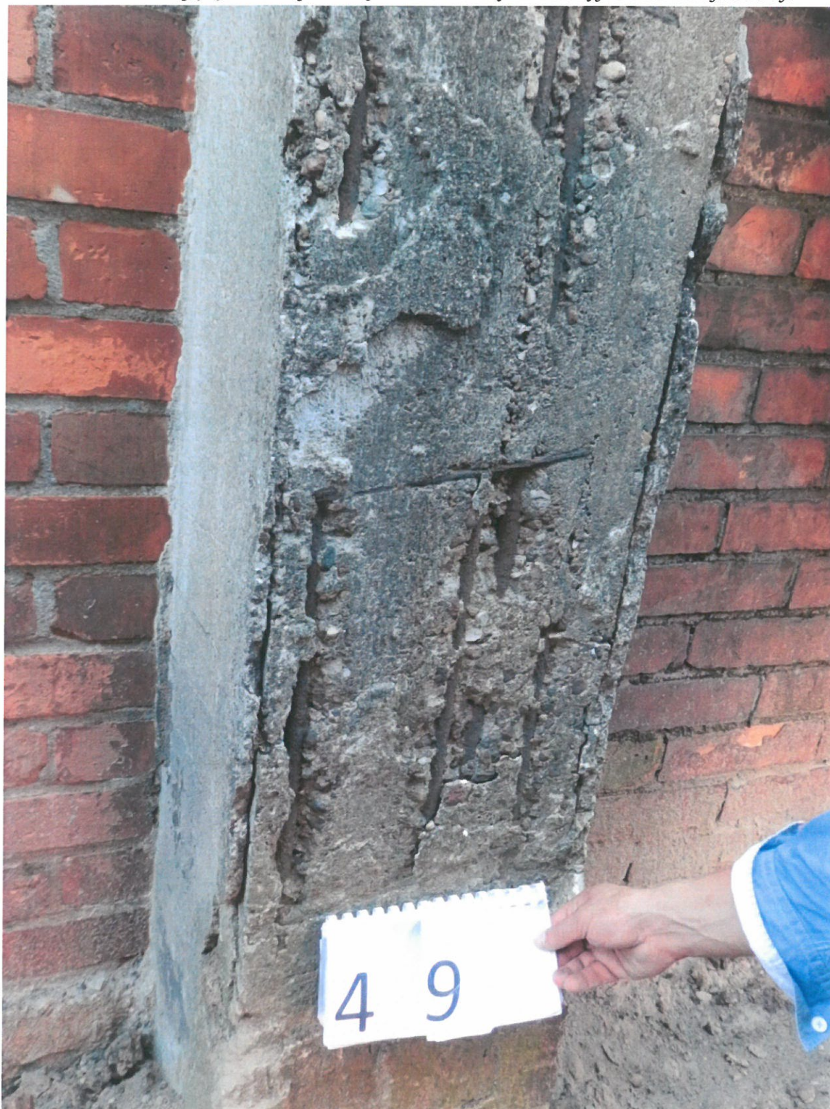
Fot. 49. Uszkodzenie betonu w dolnej części słupa na skutek rozsadzenia przez korodującą stal zbrojeniową. Widoczne ubytki korozyjne stali zbrojeniowej.
