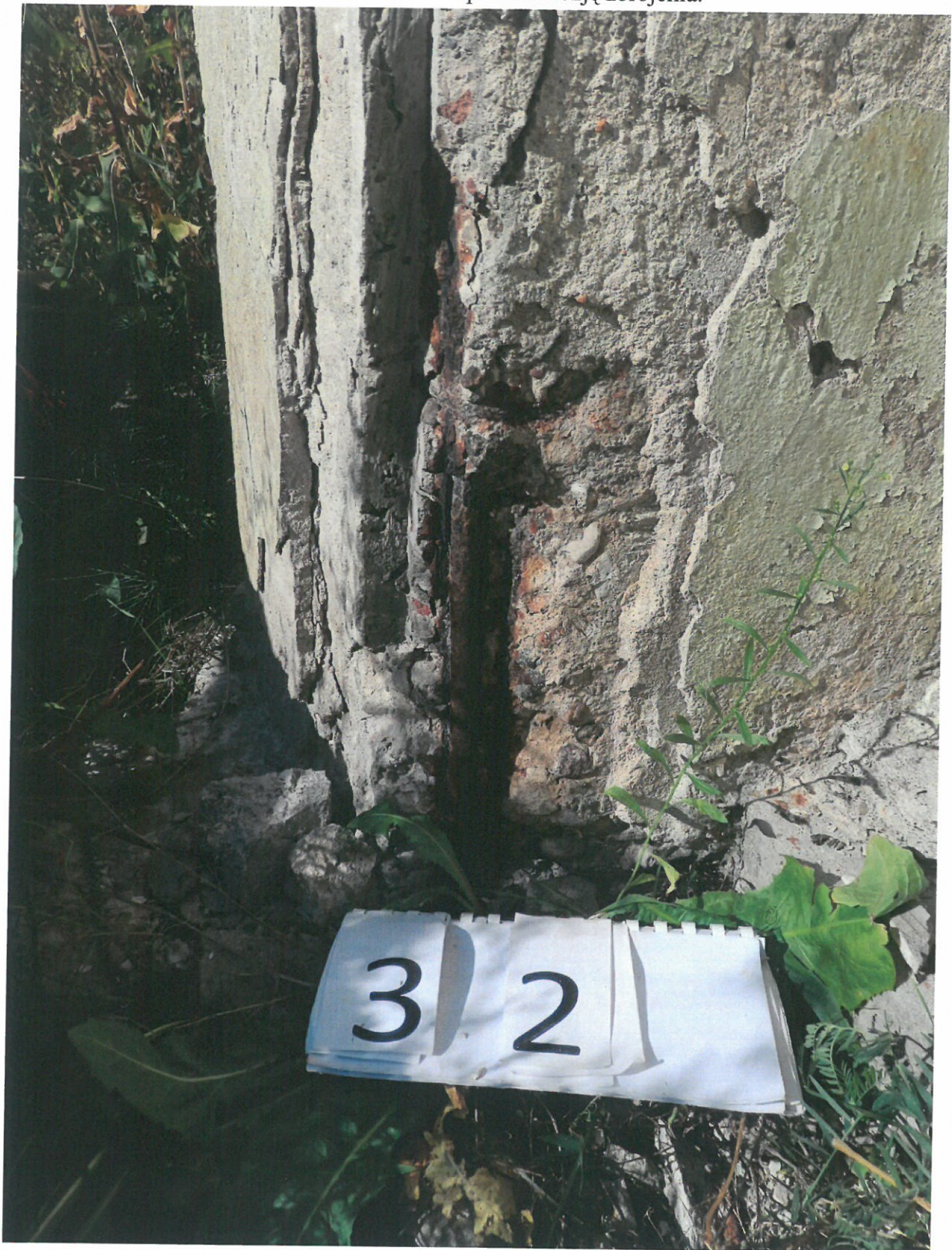
Fot. 32. Korozja zbrojenia w dolnej części słupa i uszkodzenie betonu na skutek rozsądzenia przez korozję zbrojenia.
