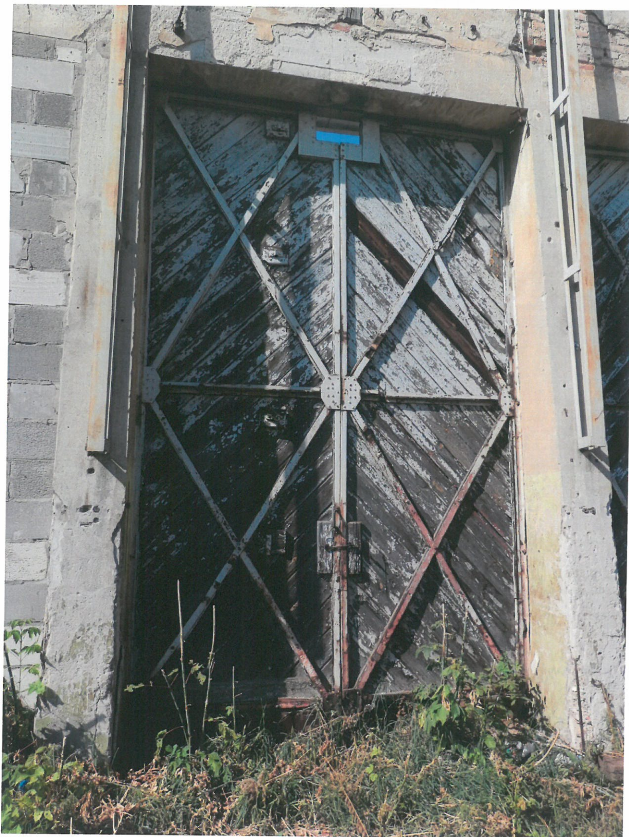
Fot. X. Wrota drewniano stalowe – zniszczone przez korozję
