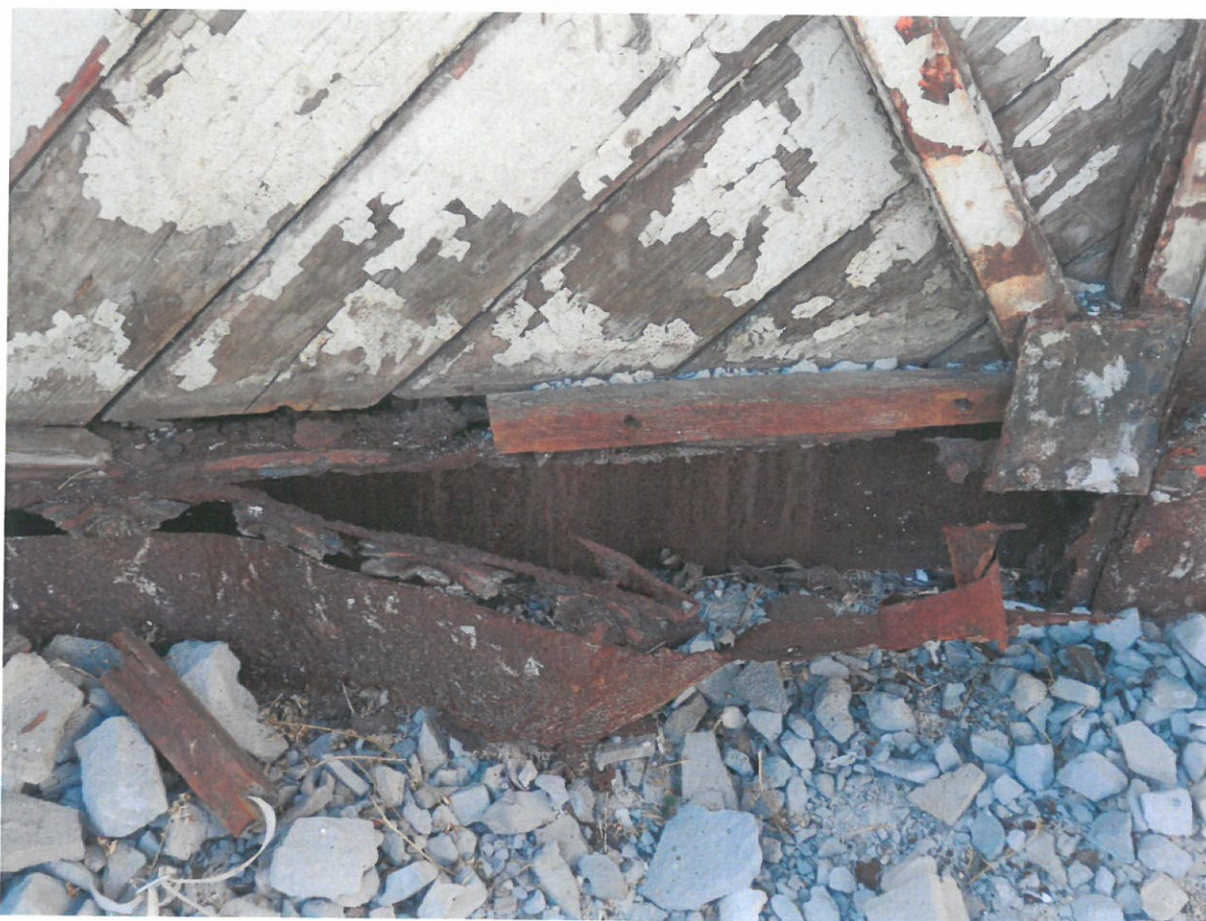
Fot. XII. Korozja wrót drewniano stalowych w dolnej części – szczegół
