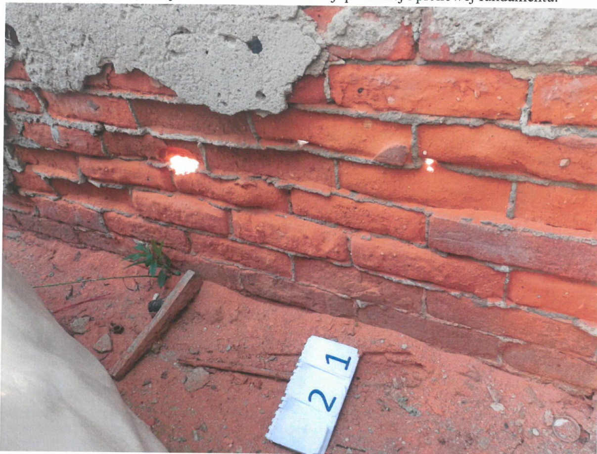
Fot. 21. Zniszczony tynki ubytki korozyjne cegły w dolnej części ściany podłużnej – zewnętrznej – na skutek braku izolacji poziomej i pionowej fundamentu.
