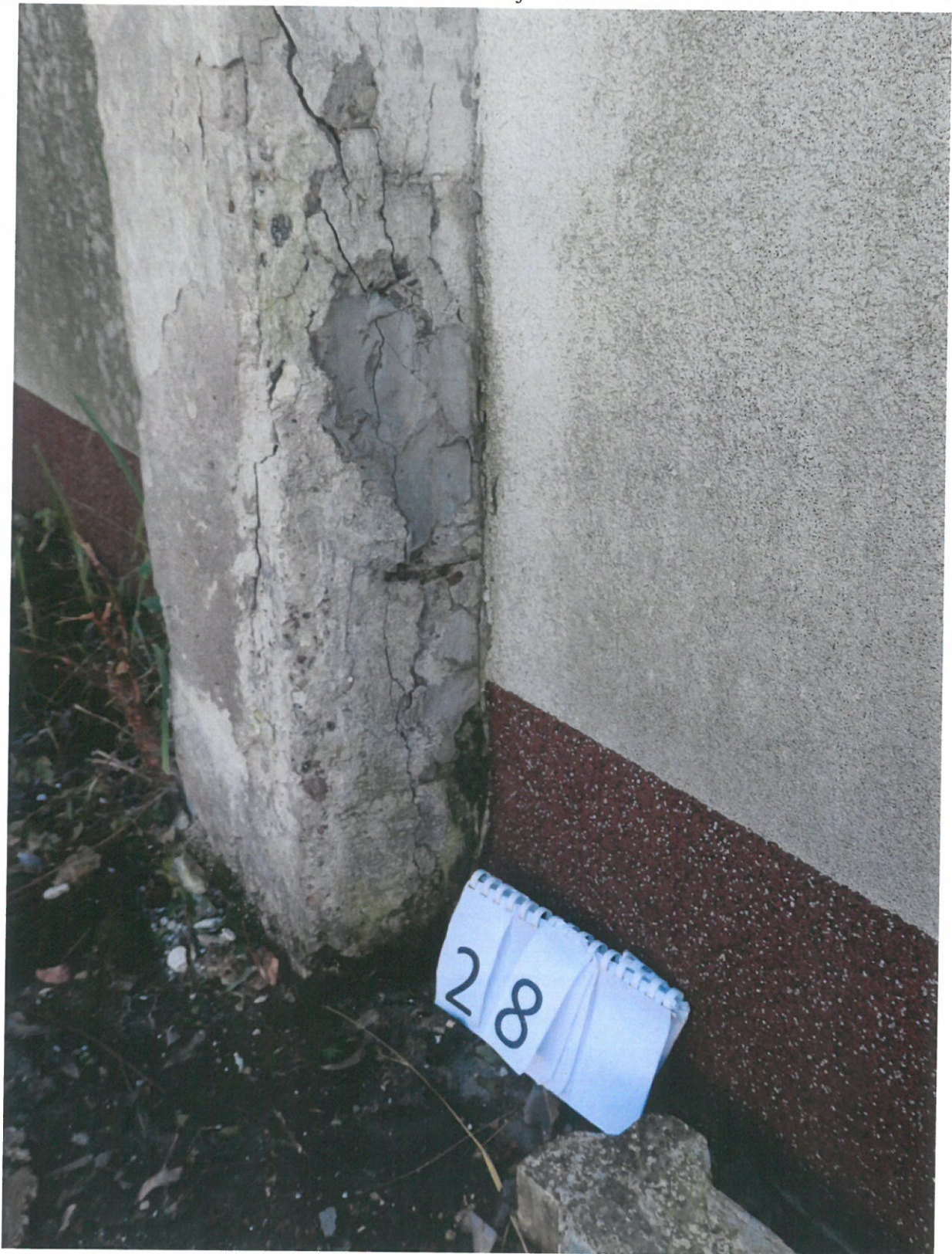
Fot. 28. Spękany beton słupa w dolnej części – na skutek rozsadzenia przez korodujące zbrojenie.
