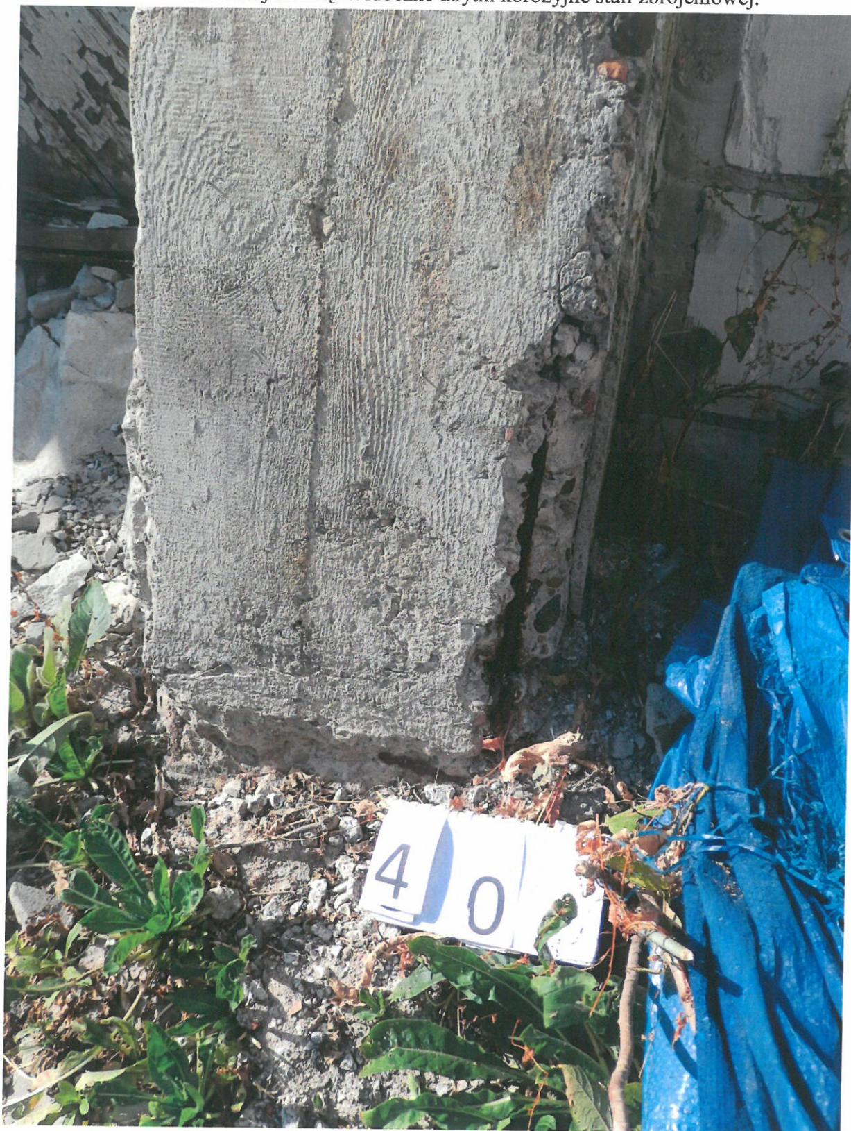
Fot. 40. Ubytki betonu w dolnej części słupa na skutek rozsadzenia przez korodującą stal zbrojeniową. Widoczne ubytki korozyjne stali zbrojeniowej.
