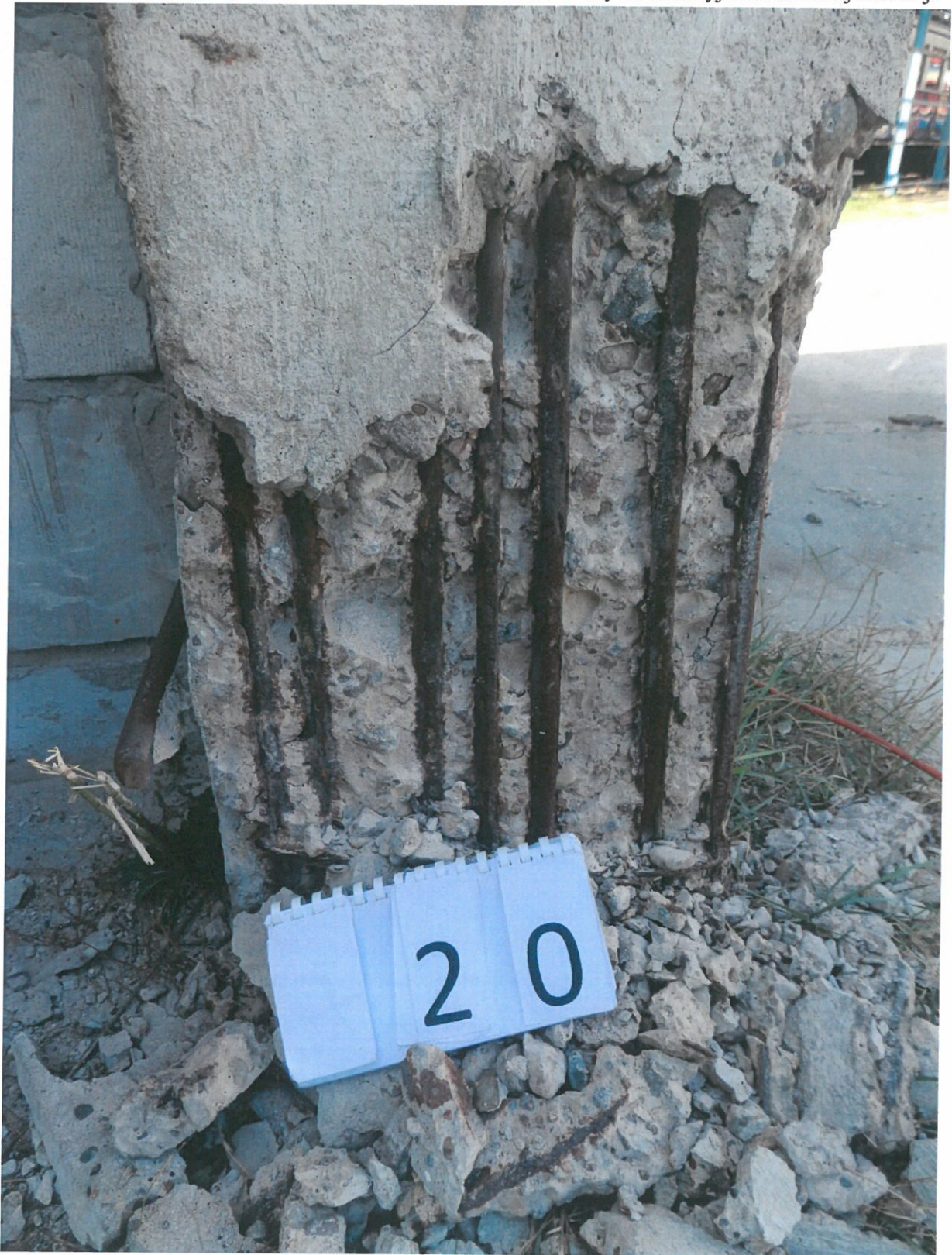
Fot. 20. Zbrojenie słupa od strony wewnętrznej. Korozja zbrojenia w dolnej części słupa przyczyną rozsądzenia betonu. Widoczne ubytki korozyjne stali zbrojeniowej.
