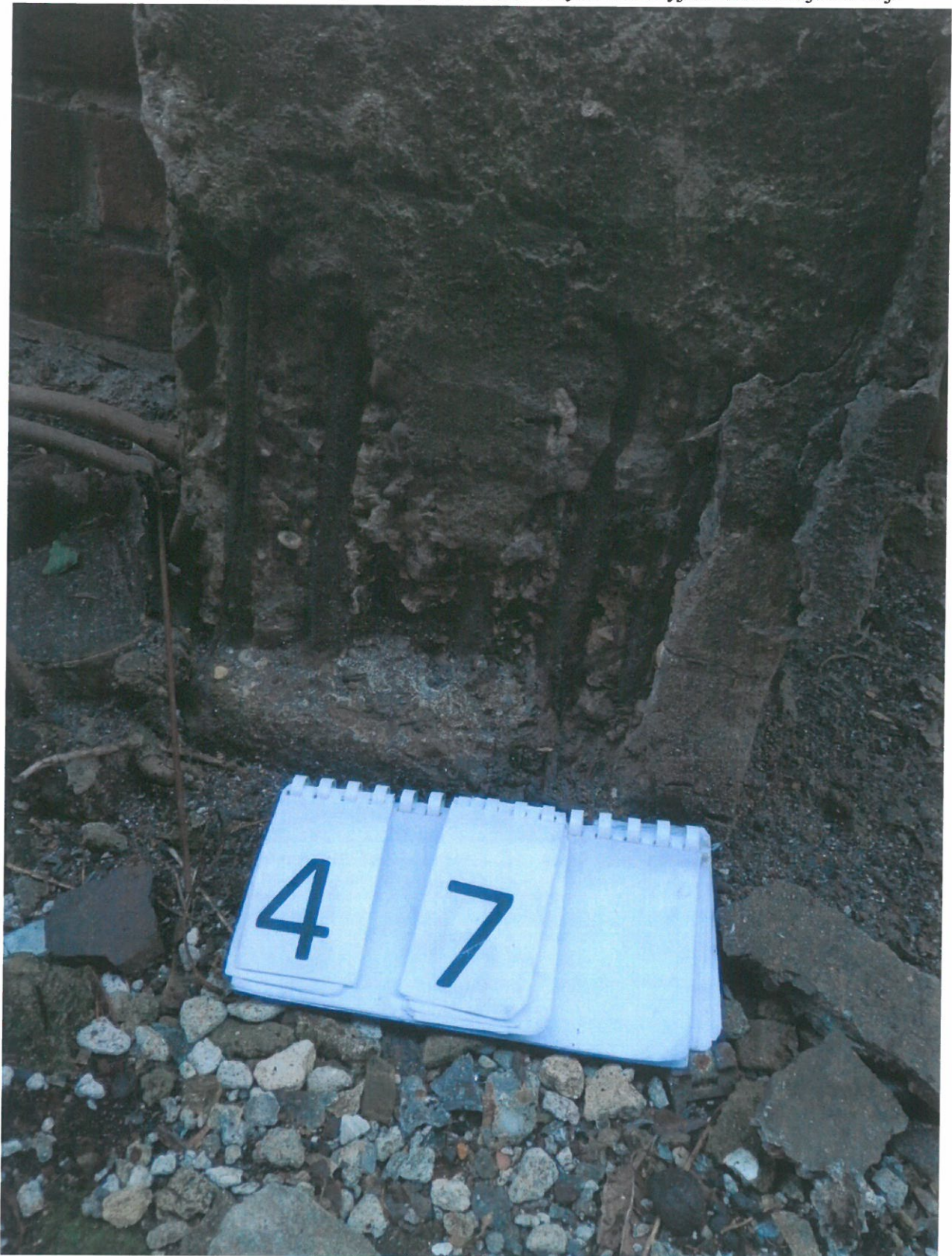
Fot. 47. Uszkodzenie betonu w dolnej części słupa na skutek rozsądzenia przez korodującą stal zbrojeniową. Widoczne ubytki korozyjne stali zbrojeniowej.
