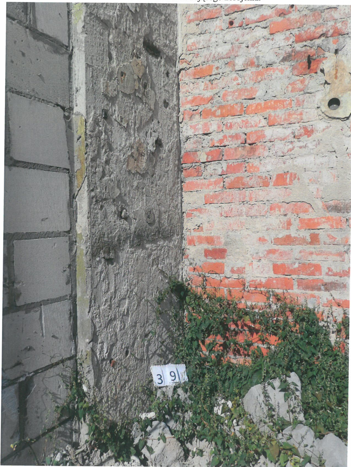
Fot. 39. Spękany beton słupa w dolnej części słupa w dolnej części słupa na skutek rozsadzenia korodującego zbrojenia.
