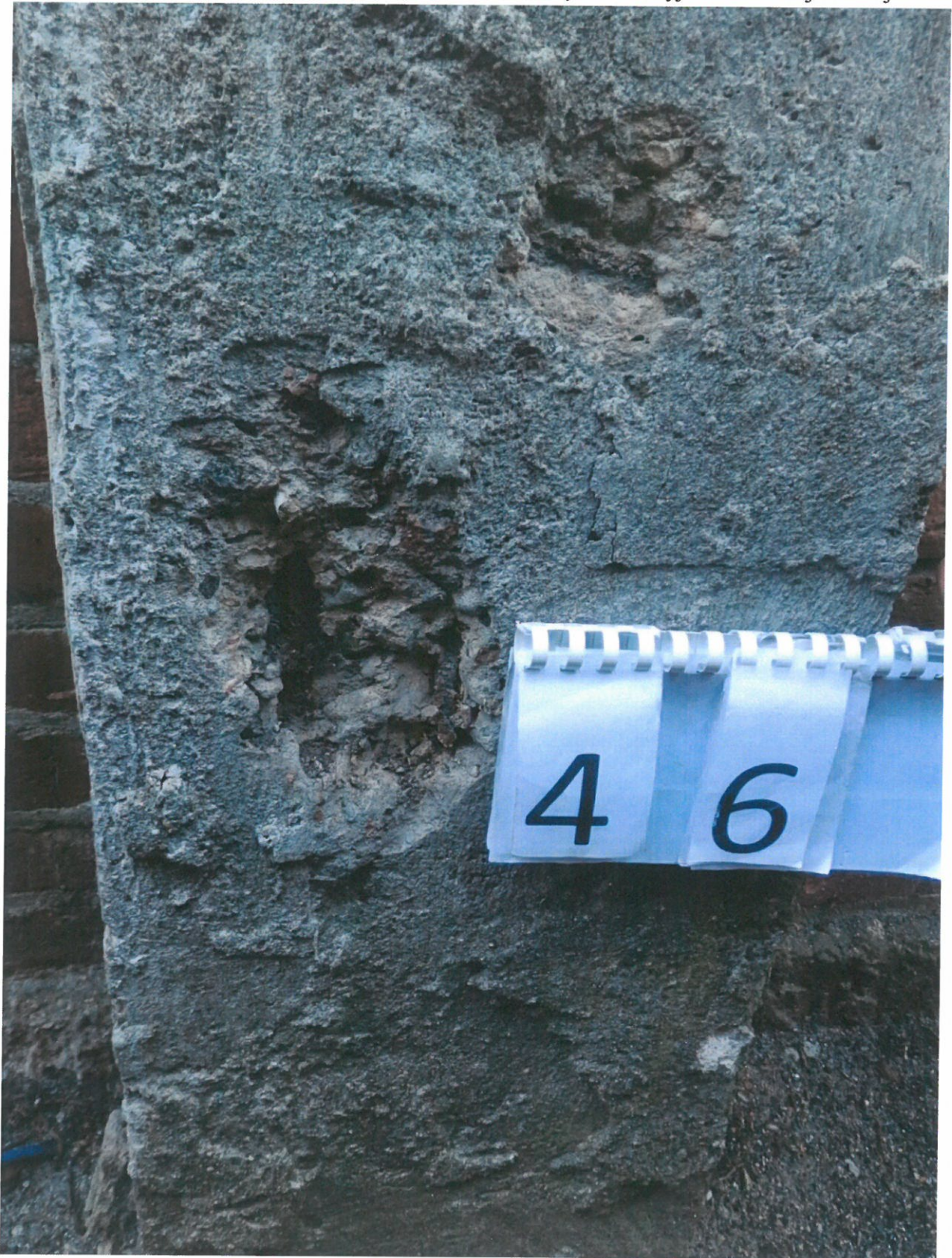
Fot. 46. Uszkodzenie betonu w dolnej części słupa na skutek rozsadzenia przez korodującą stal zbrojeniową. Widoczne ubytki korozyjne stali zbrojeniowej.
