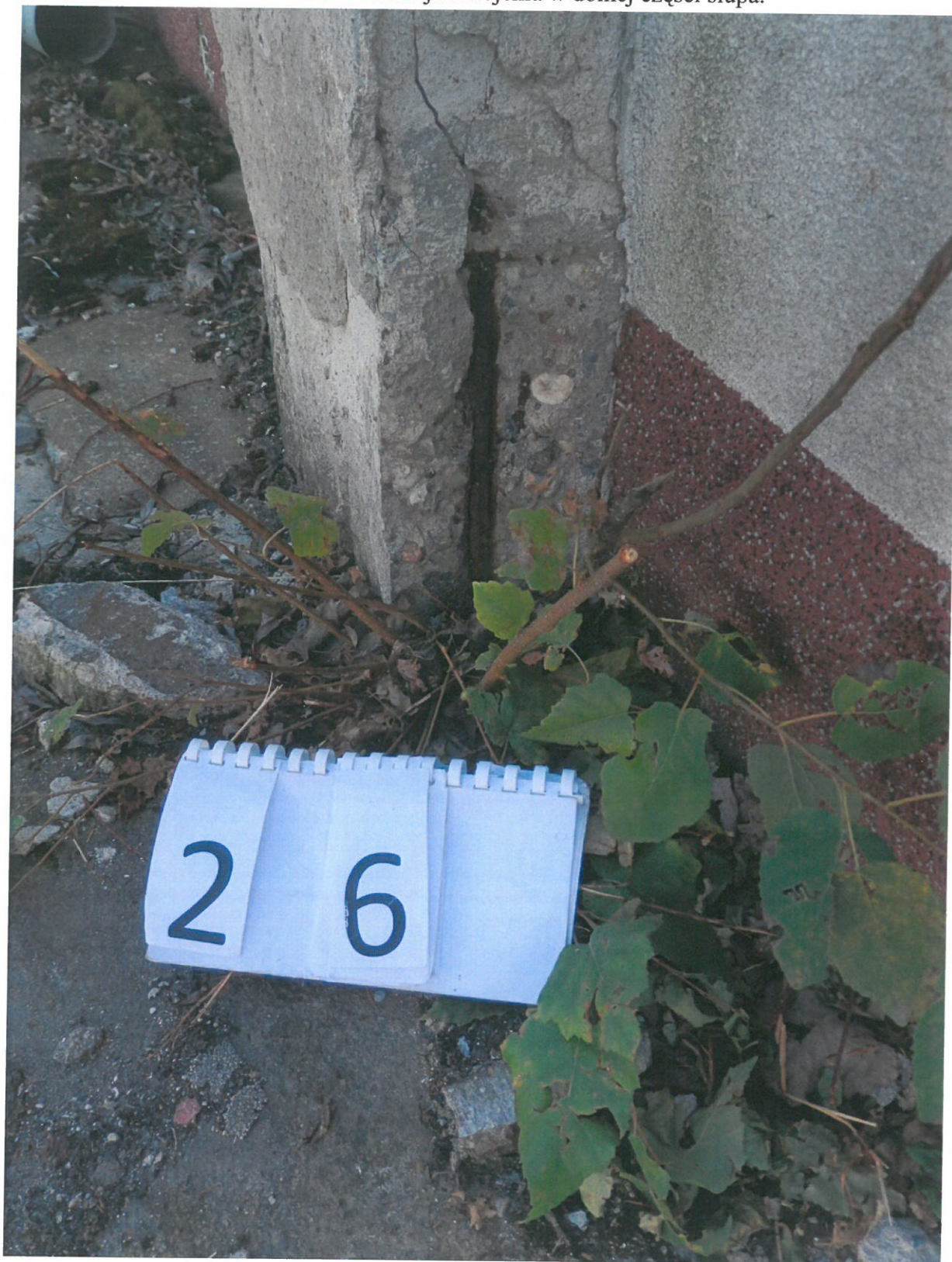
Fot. 26. Korozja zbrojenia w dolnej części słupa.
