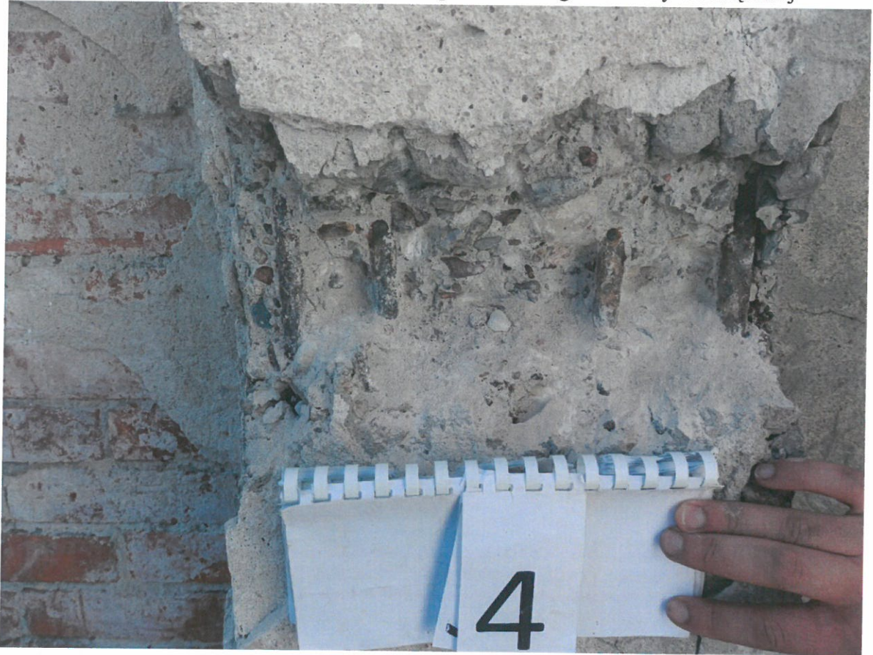
Fot. 4. Odkrywka zbrojenia słupa żelbetowego od strony wewnętrznej
