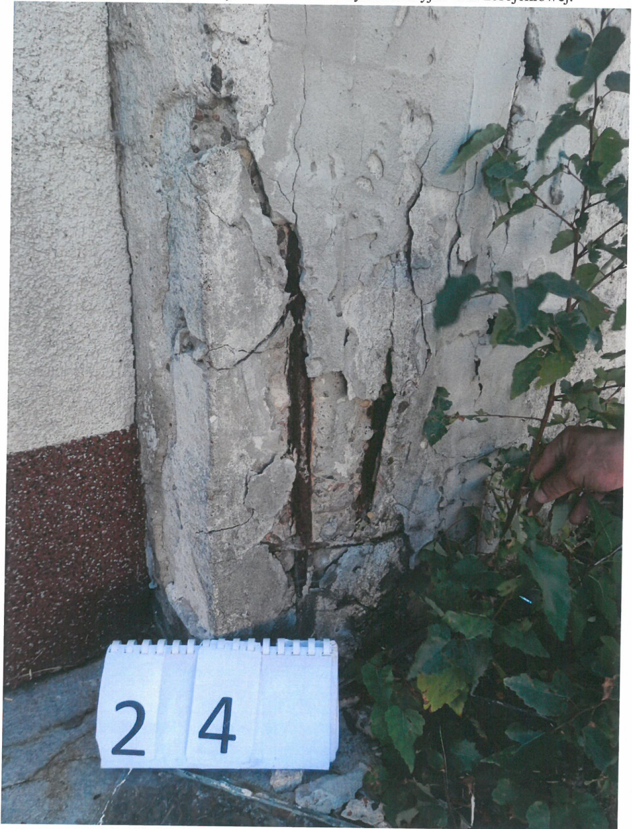
Fot. 24. Zniszczony beton słupa w dolnej części na skutek rozsadzenia przez korodujące zbrojenie. Widoczne ubytki korozyjne stali zbrojeniowej.
