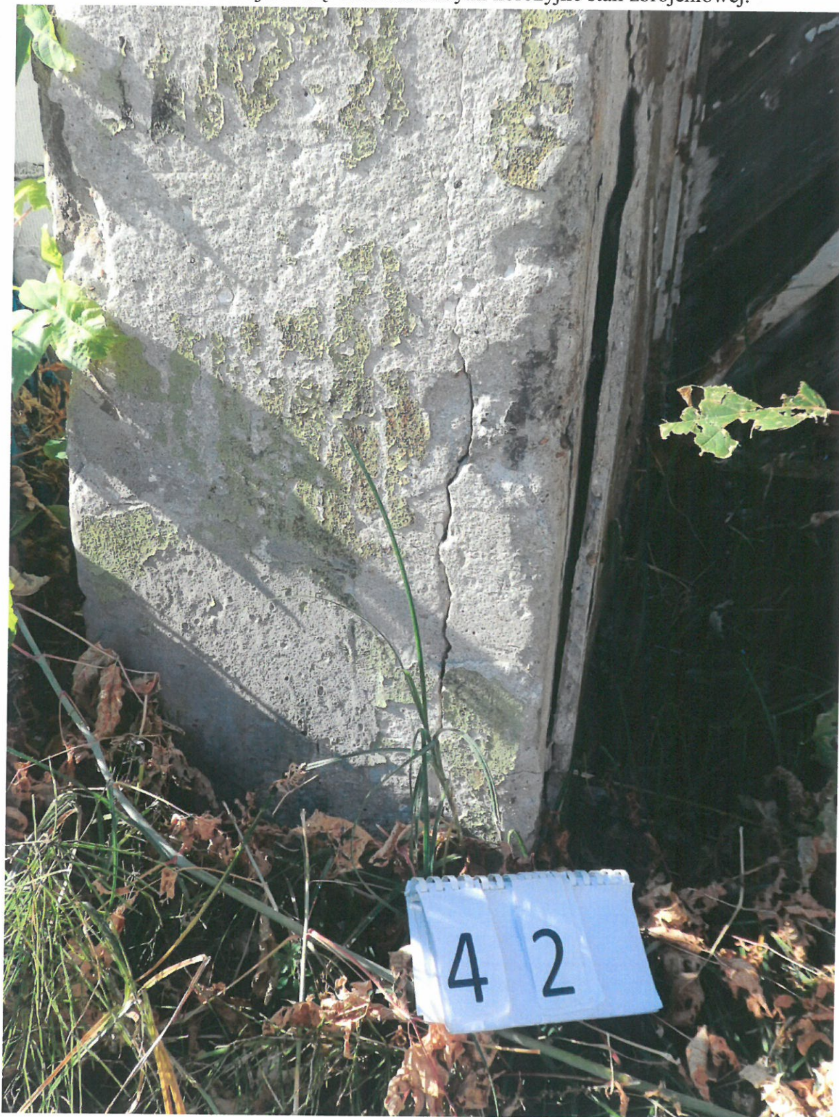
Fot. 42. Ubytki betonu w dolnej części słupa na skutek rozsadzenia przez korodującą stal zbrojeniową. Widoczne ubytki korozyjne stali zbrojeniowej.
