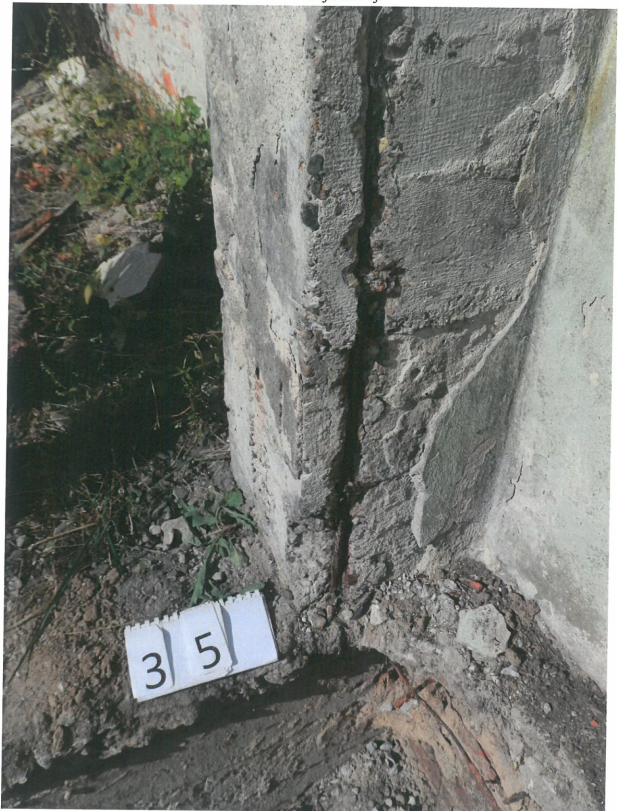
Fot. 35. Korozja zbrojenia w dolnej części słupa i uszkodzony beton na skutek rozsądzenia przez korodującą stal zbrojeniową. Widoczne ubytki korozyjne stali zbrojeniowej.
