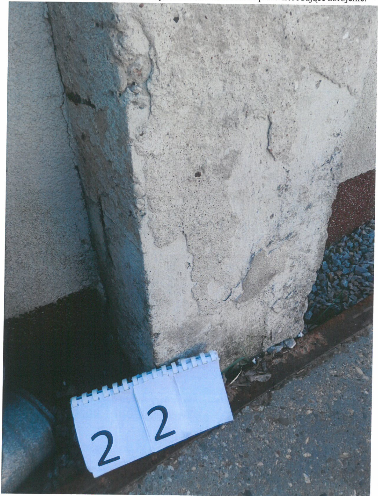
Fot. 22. Pęknięcie betonu słupa na skutek rozsądzenia przez korodujące zbrojenie.
