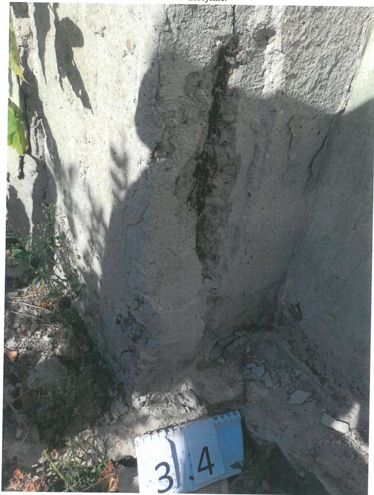
Fot. 34. Pęknięcie betonu w dolnej części słupa na skutek rozsadzenia przez korodujące zbrojenie.
