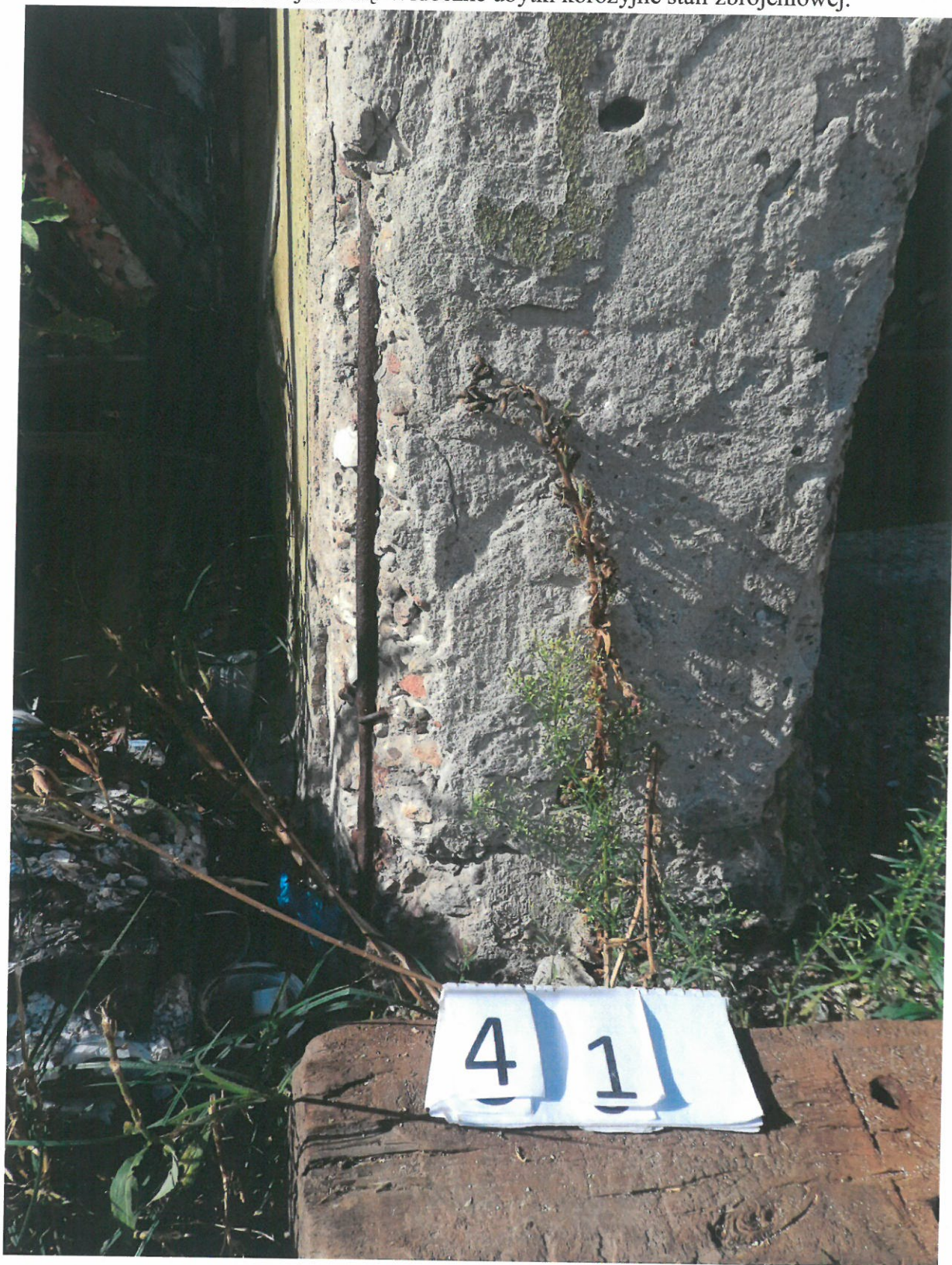
Fot. 41. Ubytki betonu w dolnej części słupa na skutek rozsadzenia przez korodującą stal zbrojeniową. Widoczne ubytki korozyjne stali zbrojeniowej.
