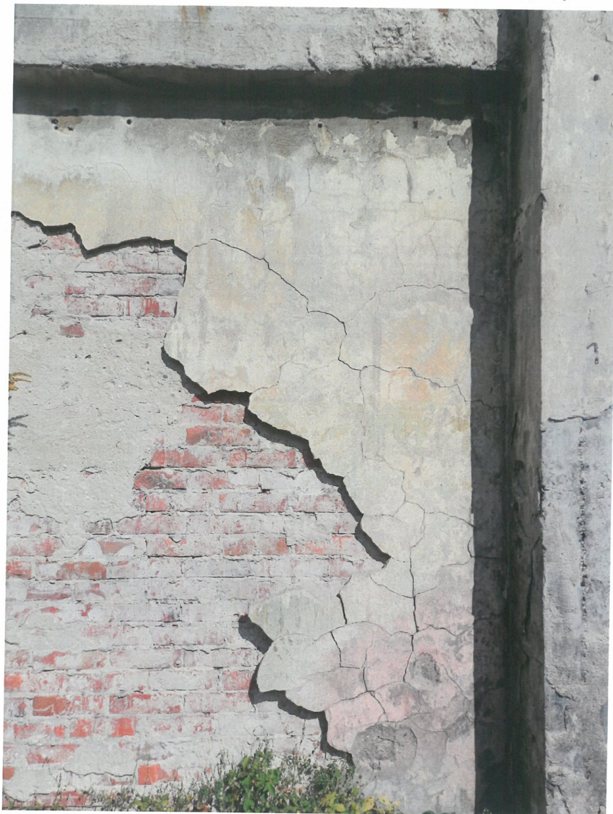
Fot. XIII. Korozyja tynków na ścianach podłużnych od strony wewnętrznej
