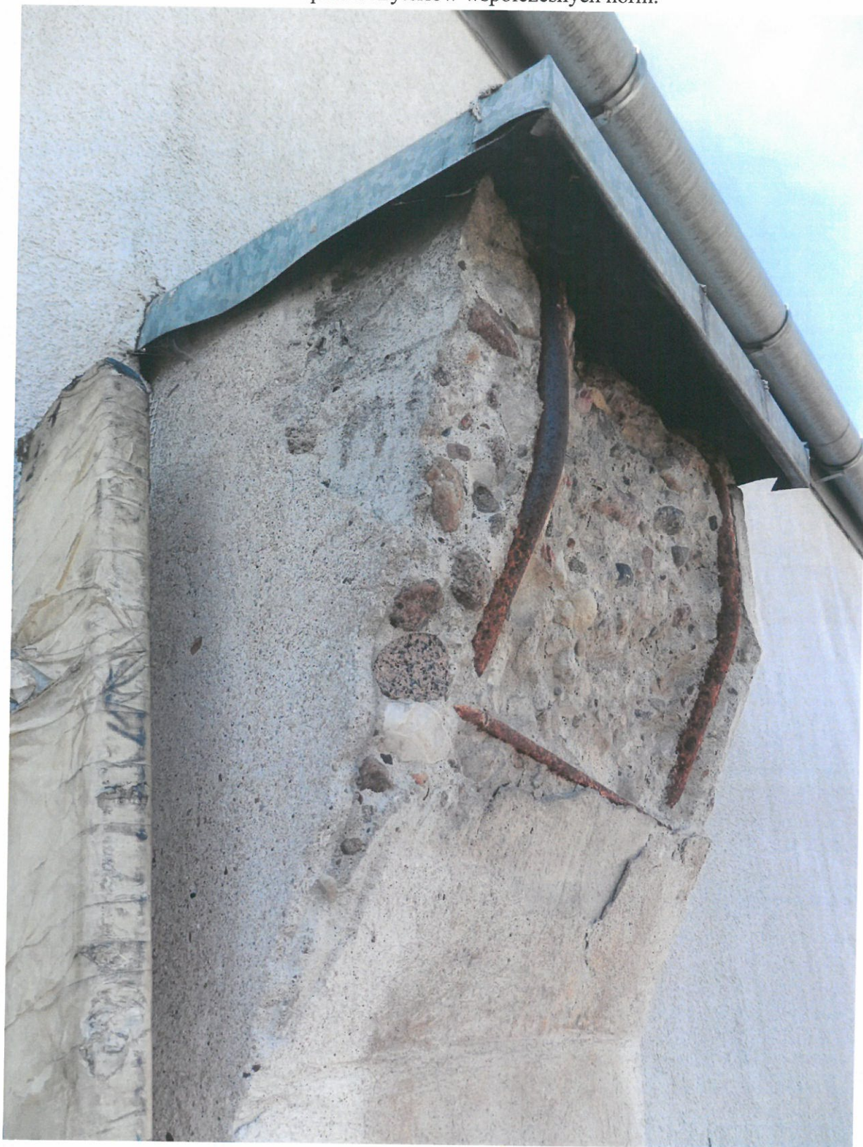
Fot. 5. Zbrojenie krótkiego wspornika żelbetowego słupa. Istniejące zbrojenie nie spełnia kryteriów współczesnych norm.
