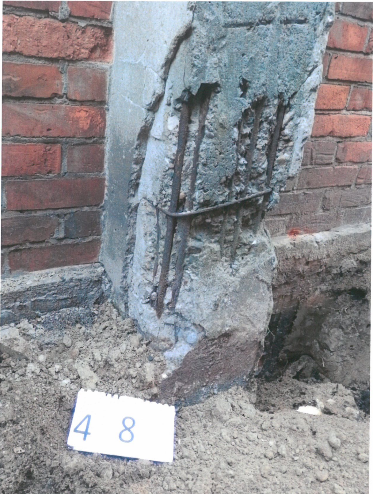
Fot. 48. Uszkodzenie betonu w dolnej części słupa na skutek rozsądzenia przez korodującą stal zbrojeniową. Widoczne ubytki korozyjne stali zbrojeniowej.
