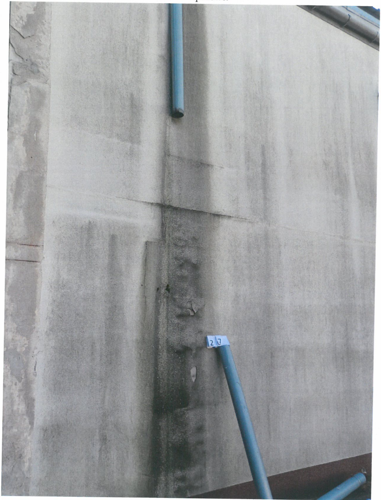
Fot. 27. Uszkodzona rura spustowa powoduje zalewanie ściany zachodniej przez wody opadowe.
