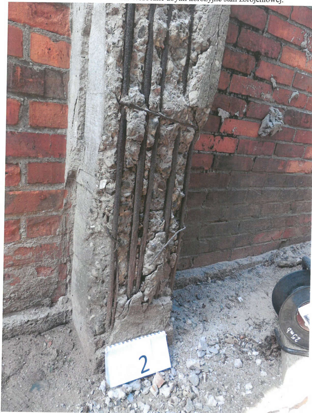
Fot. 2. Zbrojenie słupa. Korozja zbrojenia w dolnej części słupa przyczyną rozsądzenia betonu. Widoczne ubytki korozyjne stali zbrojeniowej.
