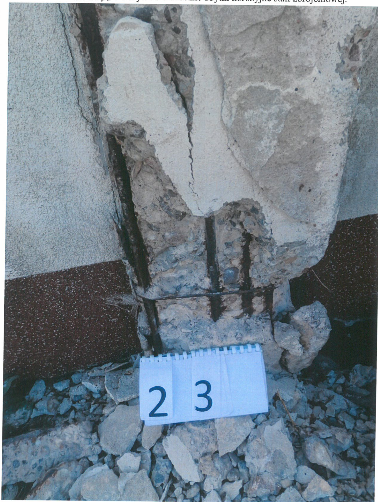
Fot. 23. Zniszczony beton słupa w dolnej części na skutek rozsadzenia przez korodujące zbrojenie. Widoczne ubytki korozyjne stali zbrojeniowej.
