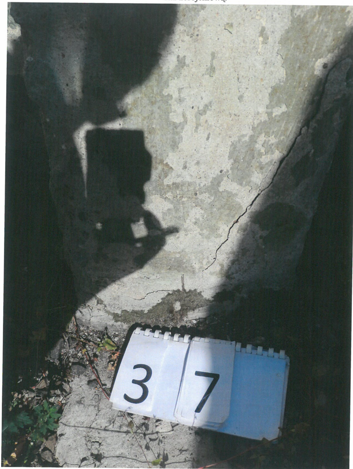
Fot. 37. Pęknięcie betonu w dolnej części słupa na skutek rozsadzenia przez korodującą stal zbrojeniową.
