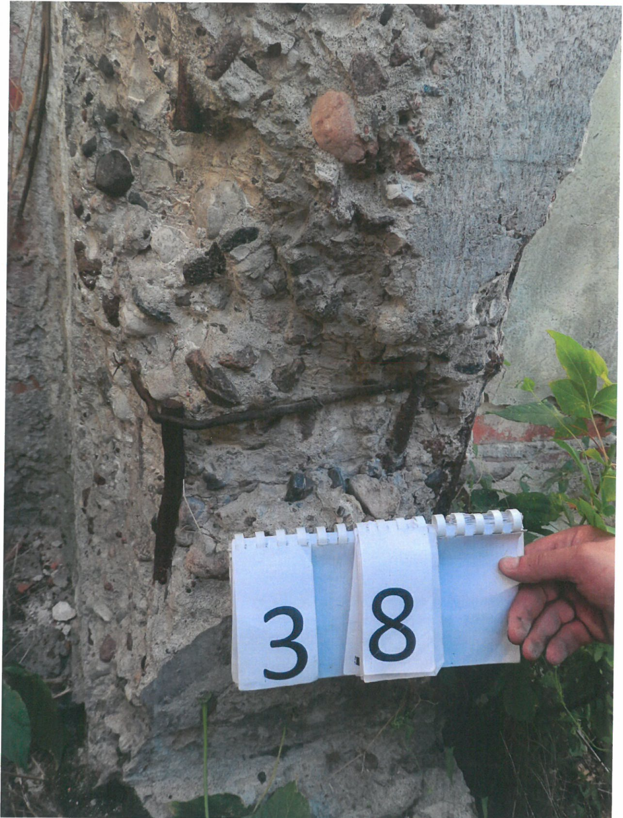
Fot. 38. Ubytki betonu w dolnej części słupa na skutek rozsadzenia przez korodujące zbrojenie. Widoczne ubytki korozyjne stali zbrojeniowej. Wycięty pręt skrajny na odcinku ok 20cm.
