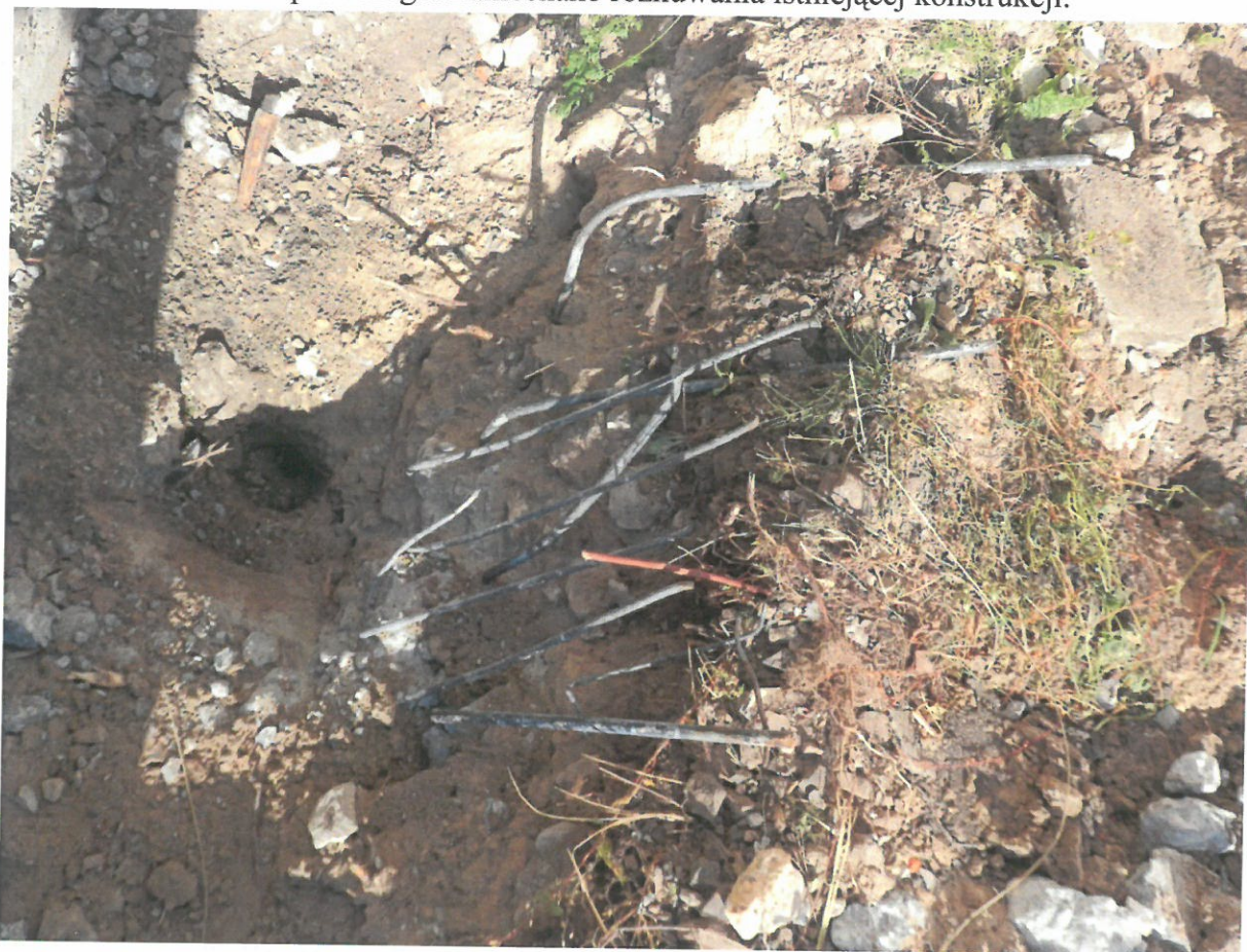
Fot. XXII. Odkrywka fundamentowa I. Widoczne zbrojenie konstrukcyjne kanału naprawczego. Zaniechano rozkuwania istniejącej konstrukcji.
