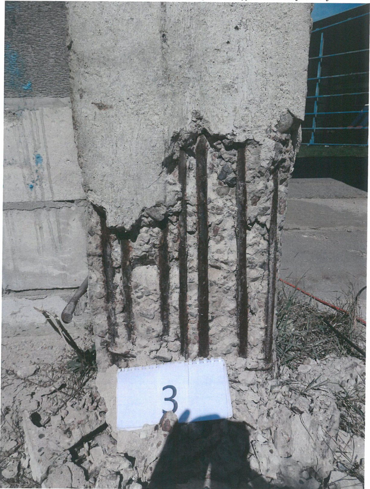
Fot. 3. Zbrojenie słupa. Korozja zbrojenia w dolnej części słupa przyczyną rozsądzenia betonu. Widoczne ubytki korozyjne stali zbrojeniowej.
