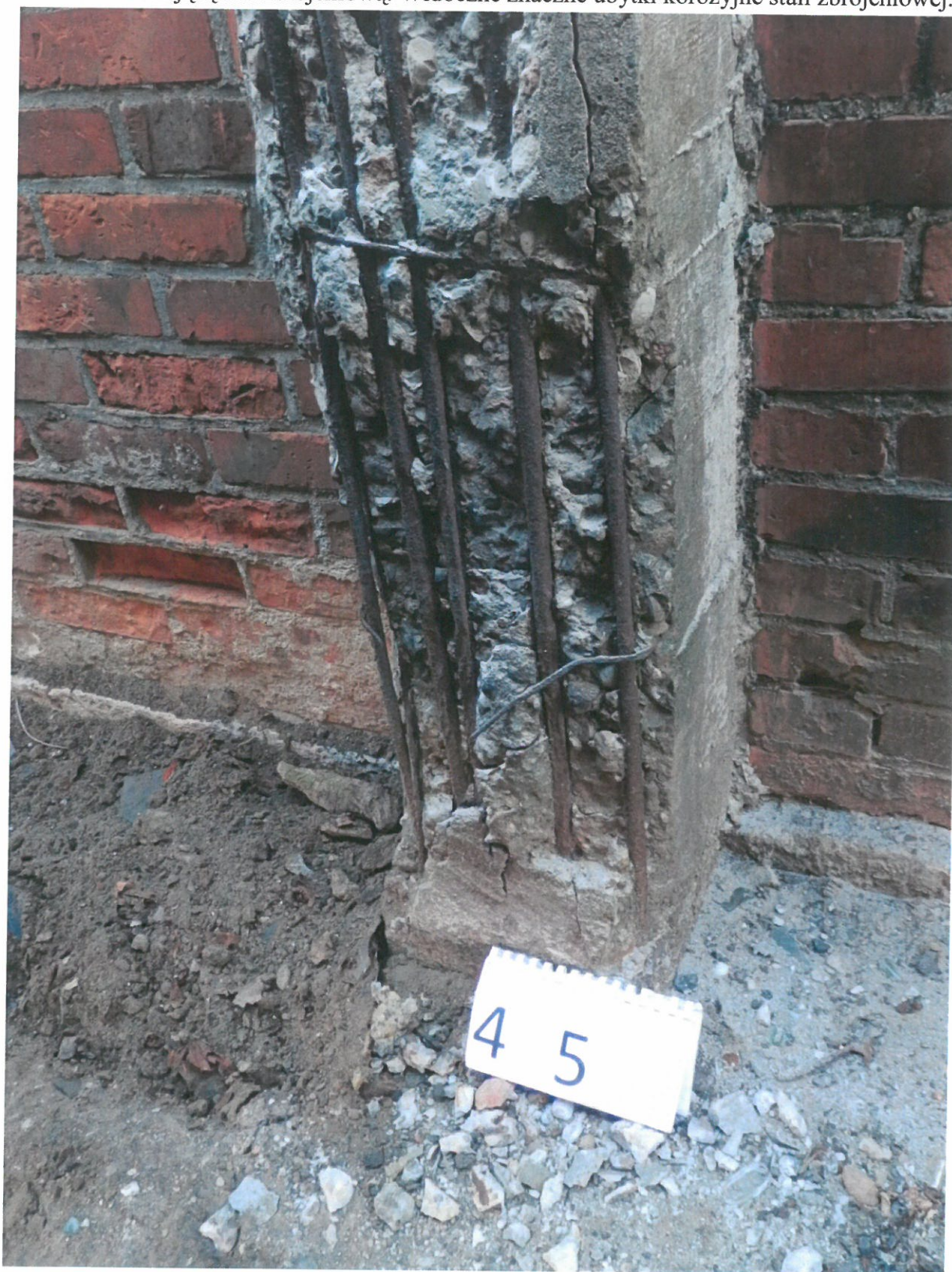
Fot. 45. Uszkodzenie betonu w dolnej części słupa na skutek rozsądzenia przez korodującą stal zbrojeniową. Widoczne znaczne ubytki korozyjne stali zbrojeniowej.
