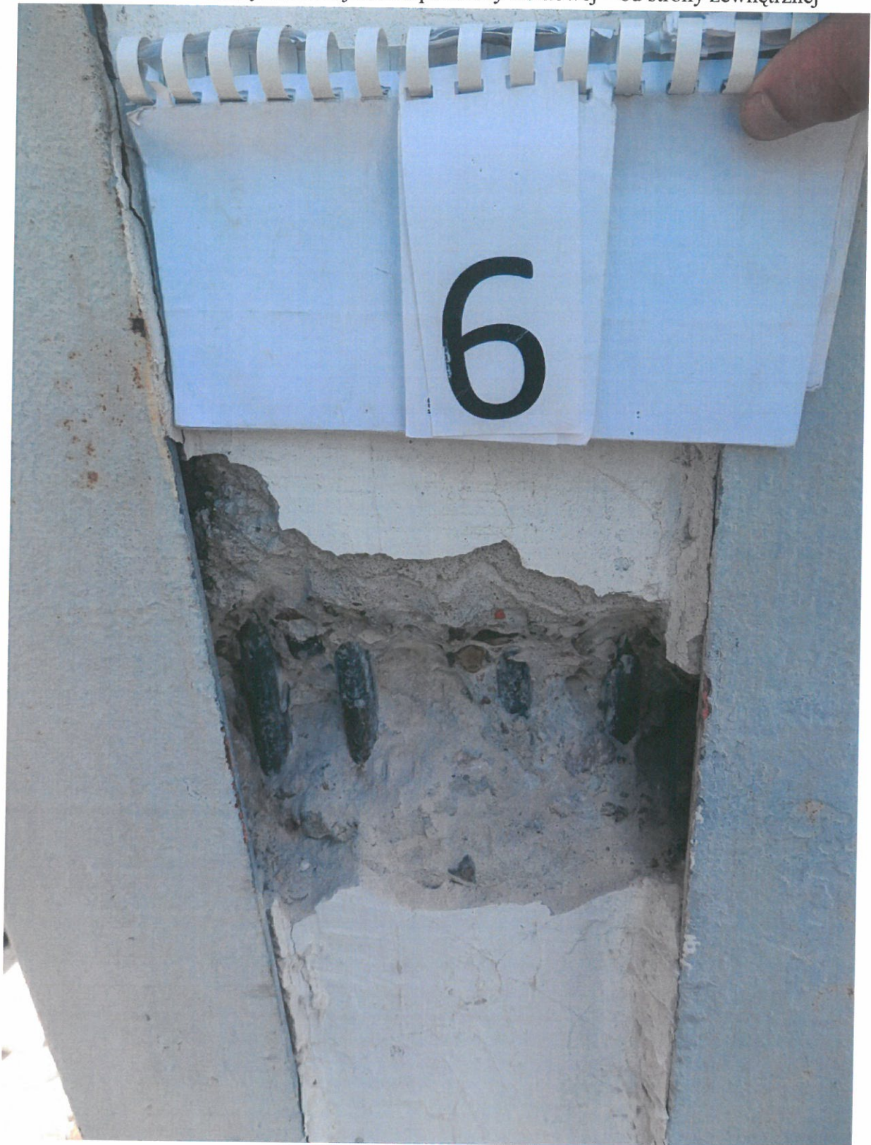
Fot. 6. Odkrywka zbrojenia słupa ściany frontowej – od strony zewnętrznej
