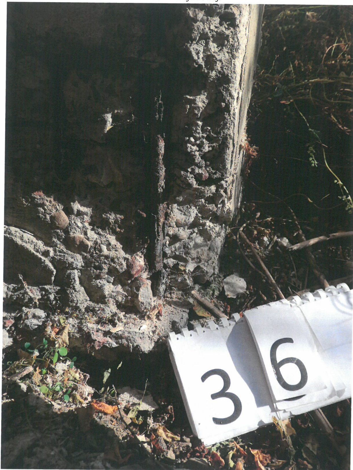
Fot. 36. Korozja zbrojenia w dolnej części słupa i uszkodzony beton na skutek rozsądzenia przez korodującą stal zbrojeniową. Widoczne ubytki korozyjne stali zbrojeniowej.
