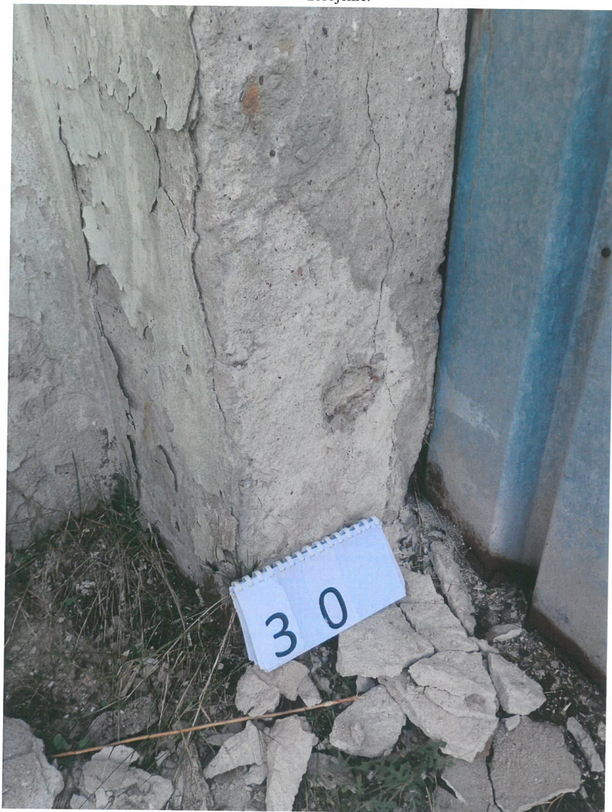
Fot. 30. Spękany beton słupa w dolnej części na skutek rozsadzenia przez korodujące zbrojenie.
