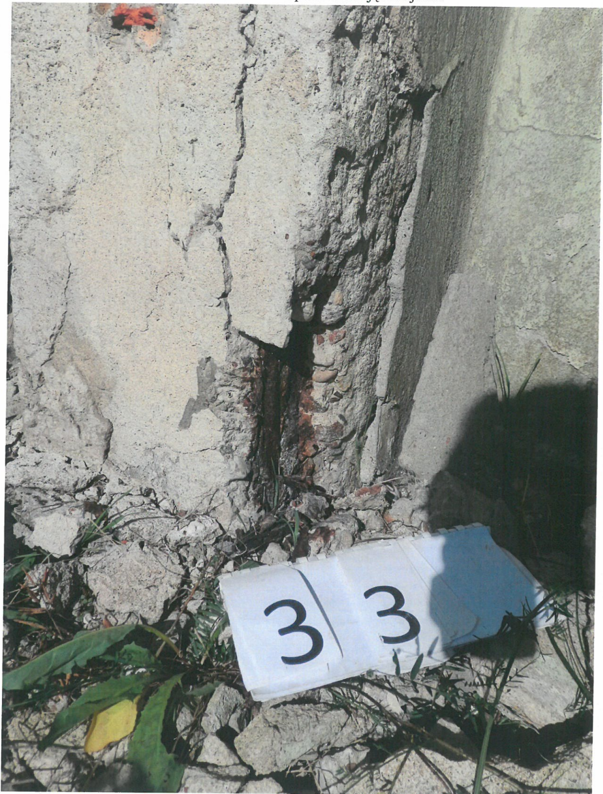
Fot. 33. Korozja zbrojenia w dolnej części słupa i uszkodzenie betonu na skutek rozsądzania przez korozję zbrojenia.
