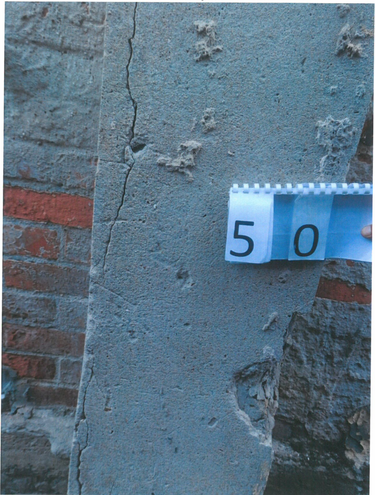
Fot. 50. Pęknięcie betonu słupa w dolnej części na skutek rozsądzenia przez korodujące zbrojenie.
