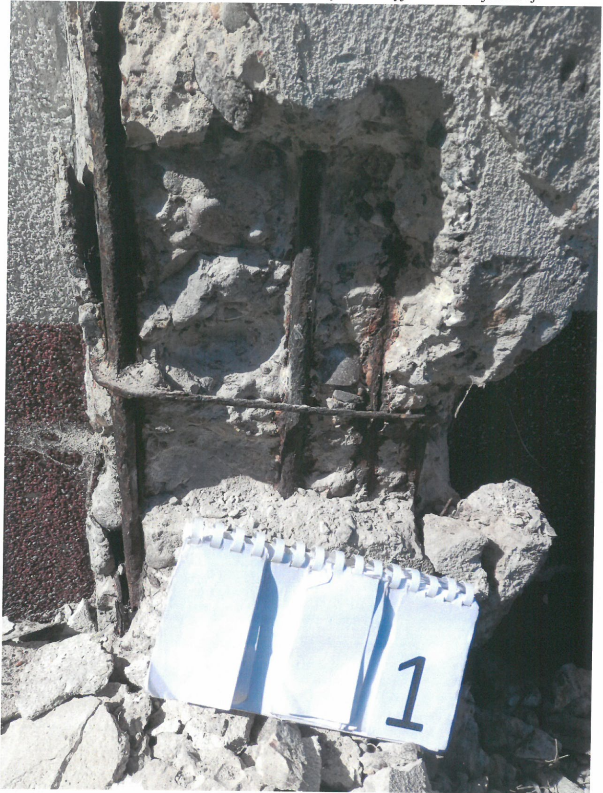
Fot. 1. Zbrojenie słupa. Korozja zbrojenia w dolnej części słupa przyczyną rozsądzenia betonu. Widoczne ubytki korozyjne stali zbrojeniowej.
