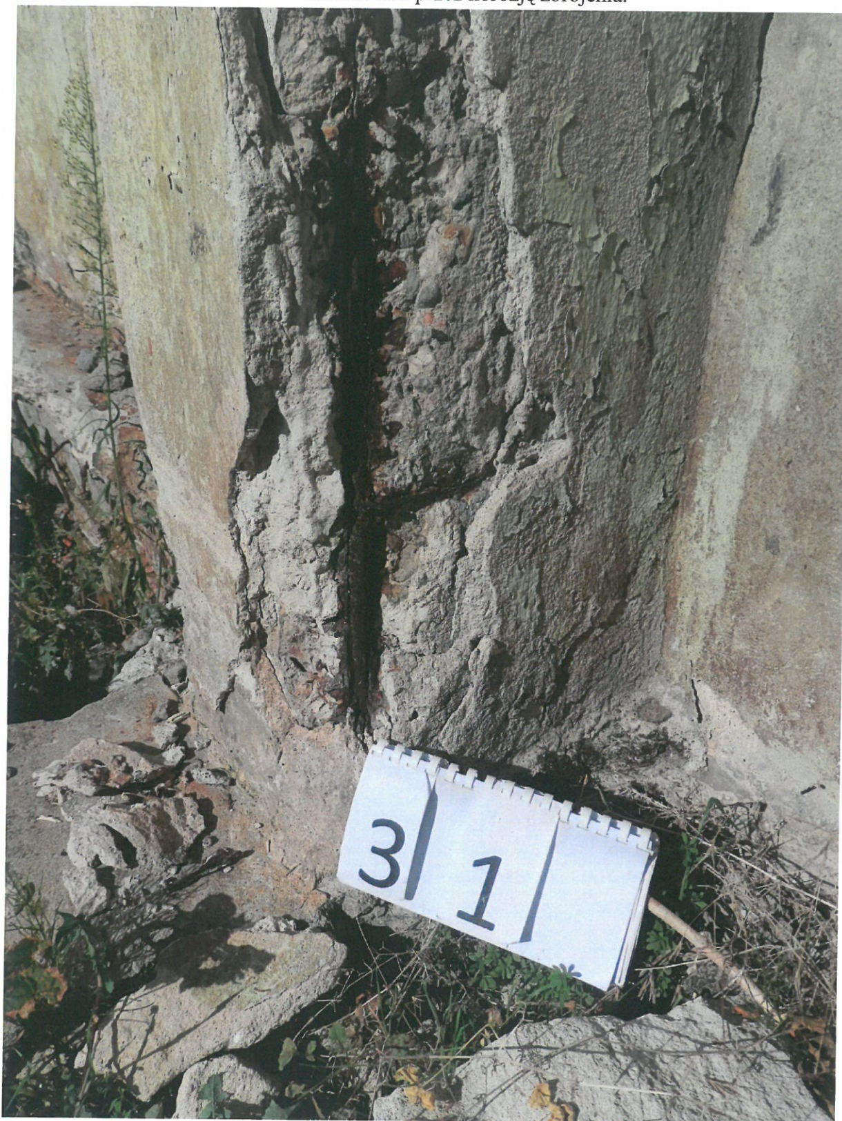
Fot. 31. Korozja zbrojenia w dolnej części słupa i uszkodzenie betonu na skutek rozsądzenia przez korozję zbrojenia.
