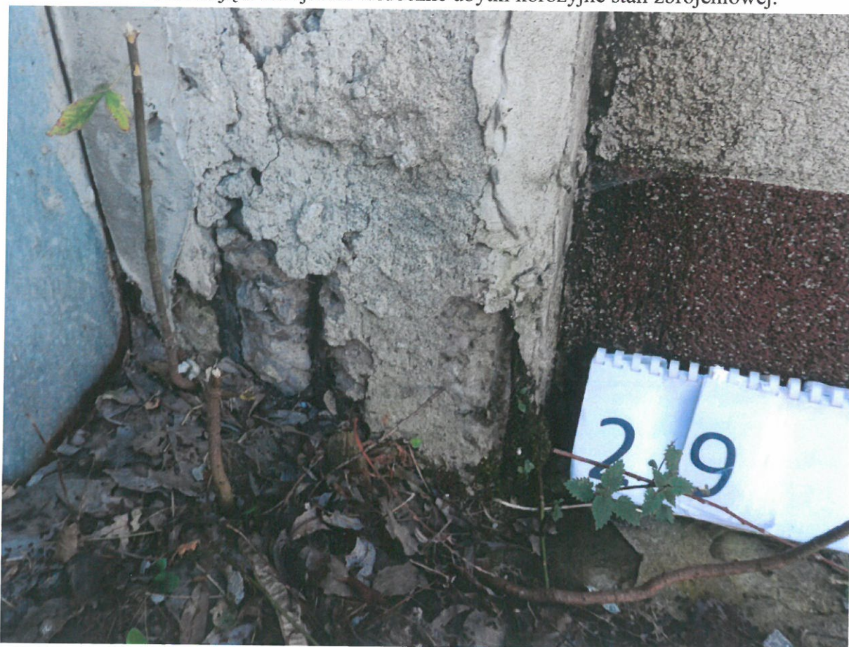
Fot. 29. Uszkodzenie betonu w dolnej części słupa na skutek rozsądzenia przez korodujące zbrojenie. Widoczne ubytki korozyjne stali zbrojeniowej.
