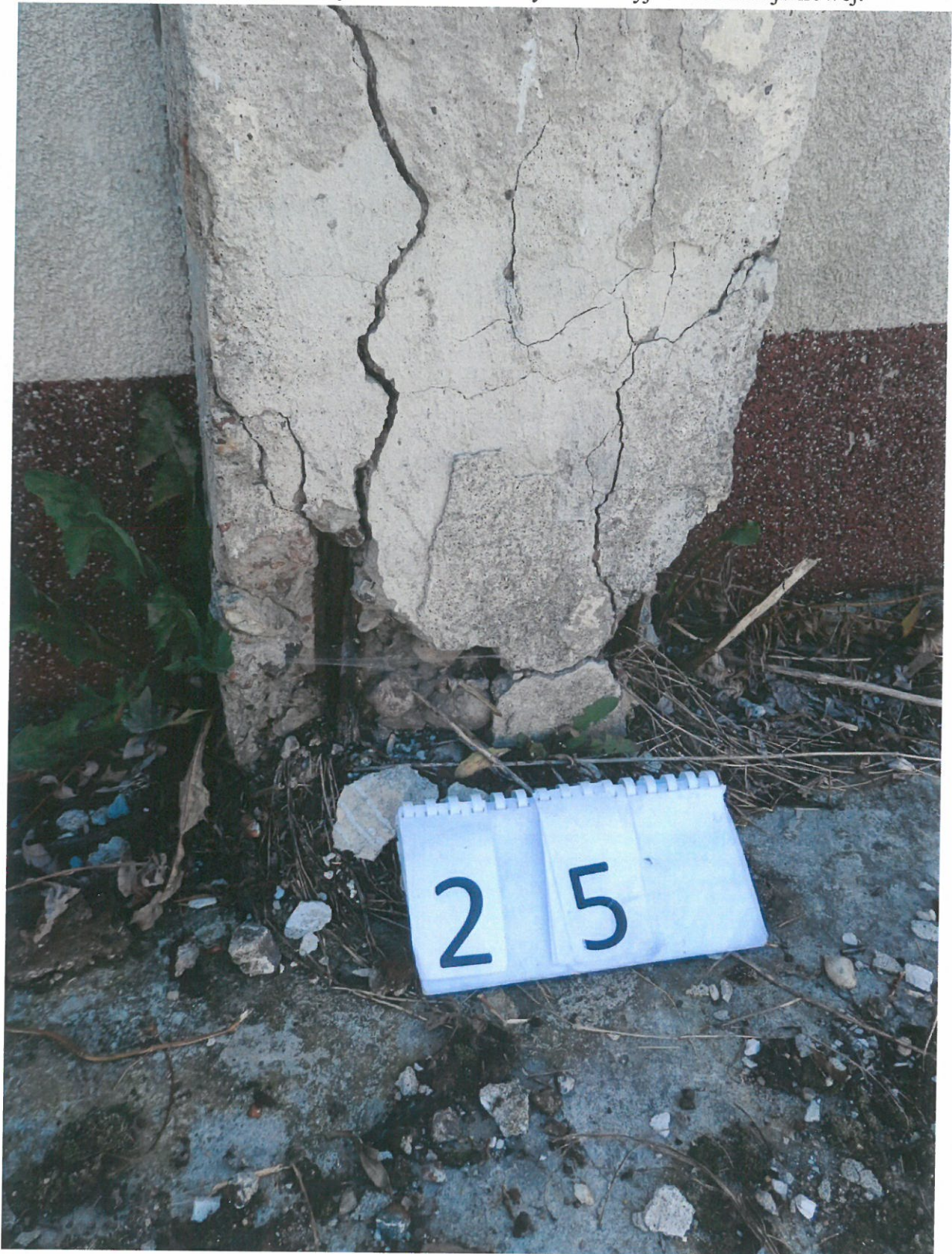
Fot. 25. Zniszczony beton słupa w dolnej części na skutek rozsadzenia przez korodujące zbrojenie. Widoczne ubytki korozyjne stali zbrojeniowej.
