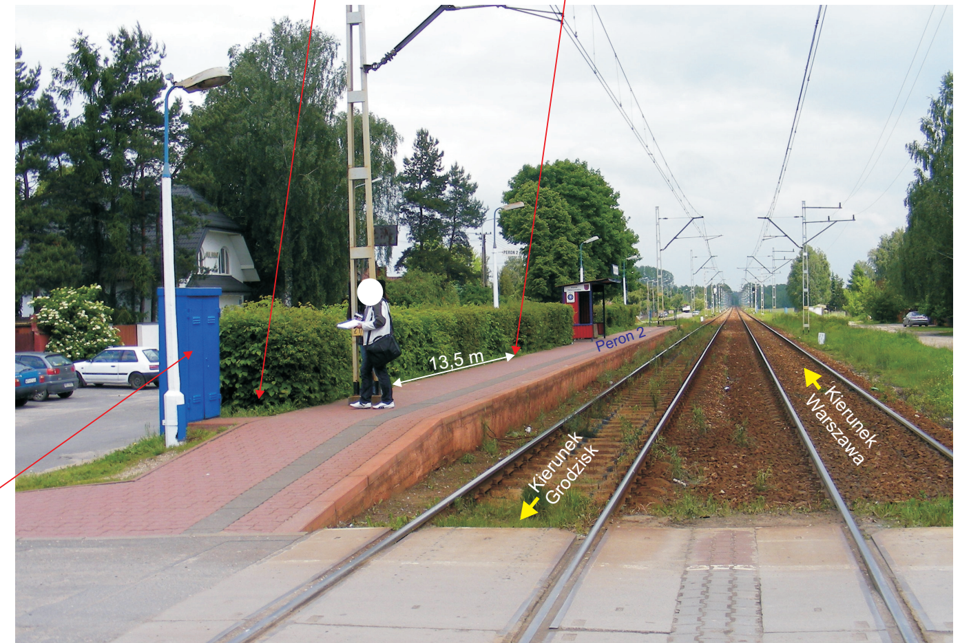
Szafa energetyczna istniejąca
